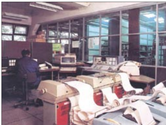
Рис. 6. Коммутационный центр Телекса и Передачи данных (АХВ 20)
